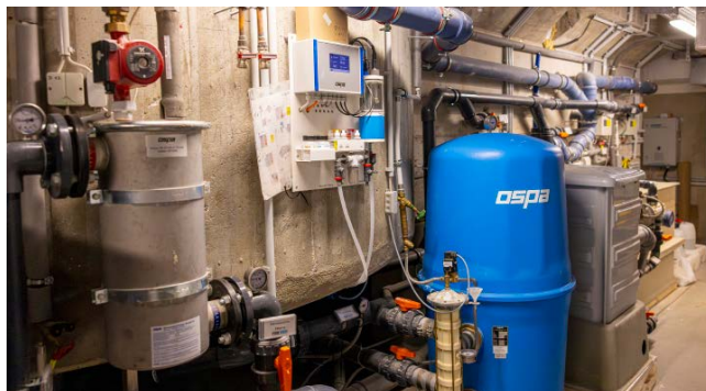
Die neu installierte, moderne Ospa-Schwimmbadtechnik im Untergeschoss der Schwimmhalle.
