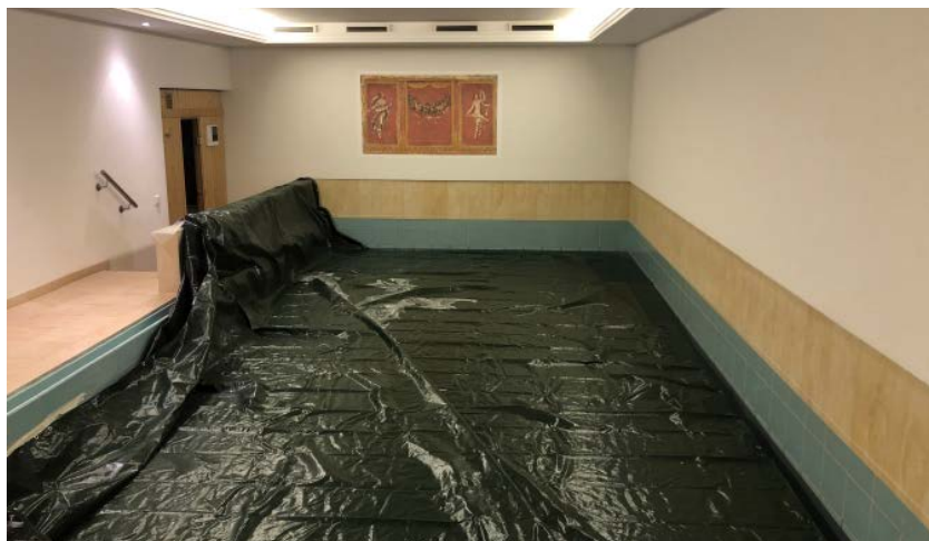
Das Bild zeigt die Schwimmhalle vor den Sanierungsarbeiten. Feuchteschäden waren nicht mehr zu übersehen und eine Generalsanierung unausweichlich.
