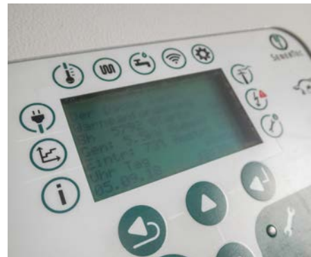
Übersichtlich: Die Steuerung der Kraftwärmekopplungsanlage.
