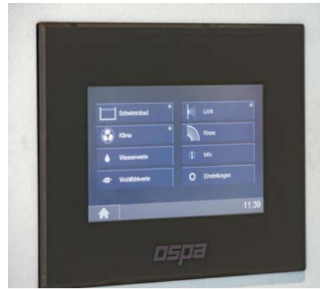
Pool-Steuerung „Ospa-Blue-Control“: Alle Wasserwerte können am Display kontrolliert werden.
