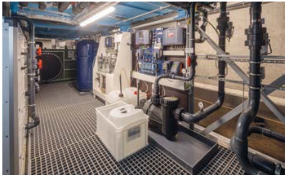
Blick in den Technikraum: Eine Etage tiefer, also im fünften Stockwerk, wurde die gesamte Schwimmbad- und Lüftungstechnik untergebracht. Das Becken ruht auf Stützen, die sich ebenfalls im fünften Stock befinden.
