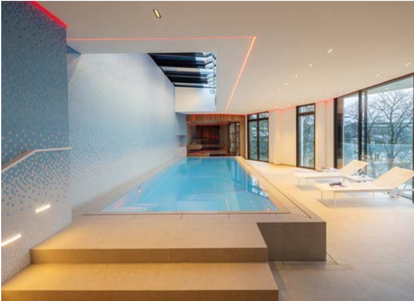
In der Decke und den Wänden wurde eine Soundanlage unsichtbar installiert. Zusammen mit dem intelligenten Beleuchtungskonzept sorgen Licht und Ton für eine stimmungsvolle Atmosphäre.
