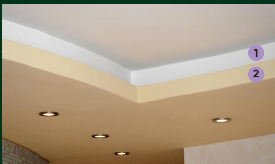
1* ISO-Deckenkante als Sichtblende 2* als Lichtblende
