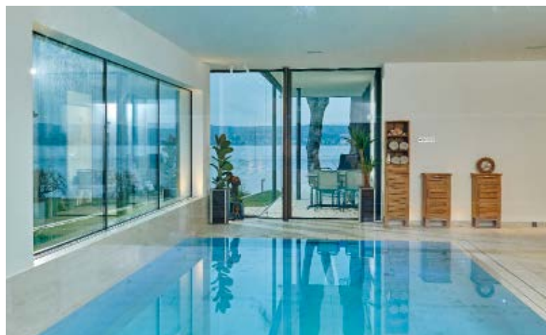
Eine gute Lüftungstechnik hält die Glasscheiben beschlagfrei.
