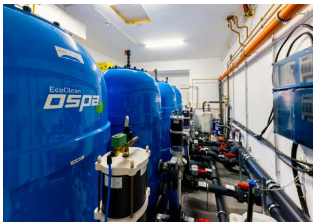
Die neue Ospa-Technik im Untergeschoss der Schwimmhalle.
