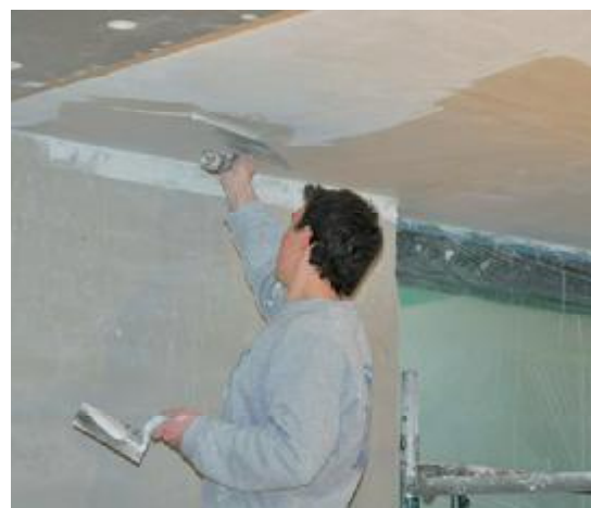
Die System-Beschichtung erfolgt direkt auf die Dampfsperre. Die hermetische Abdichtung ist damit sichergestellt.
